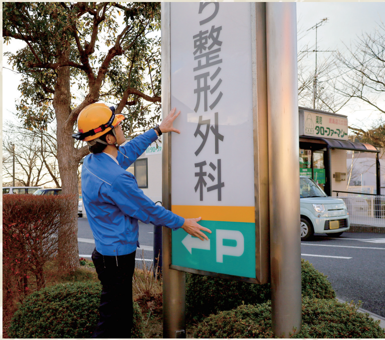
請け負った照明設備工事機器などを定期点検し、アフターフォローも欠かさない
